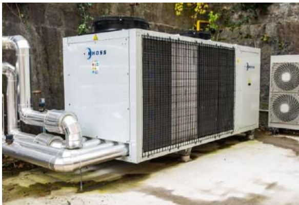
Ristagno nei filtri dei grandi impianti di condizionamento
