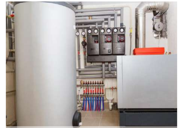
Ristagno negli impianti di produzione di acqua calda sanitaria (specie in quelli con sistema di accumulo)
